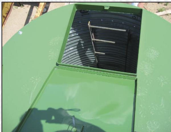
LA TRAPPE ÉTANCHE POURRAIT ÊTRE BLOQUÉE PAR DES DÉBRIS
